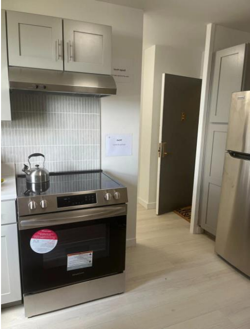
Nuevas estufas eléctricas
